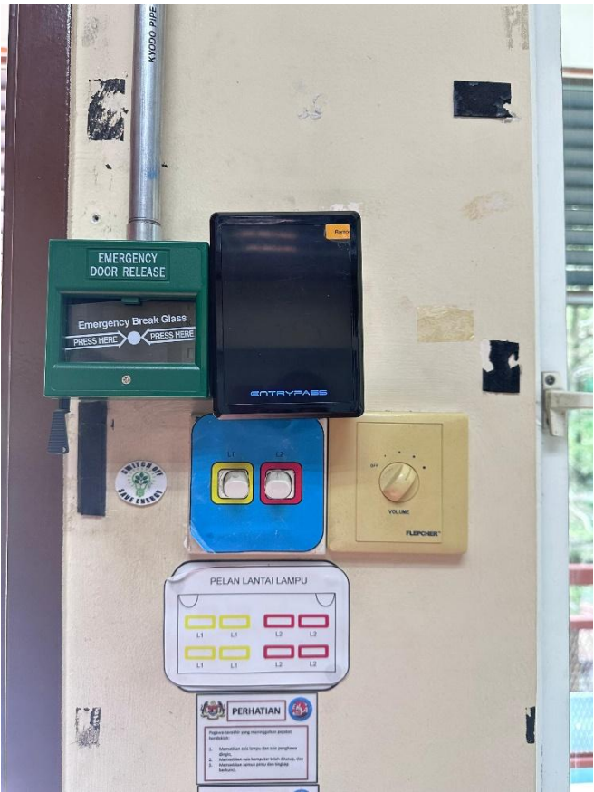
Penemuan: Keadaan dinding yang tidak bersih.
