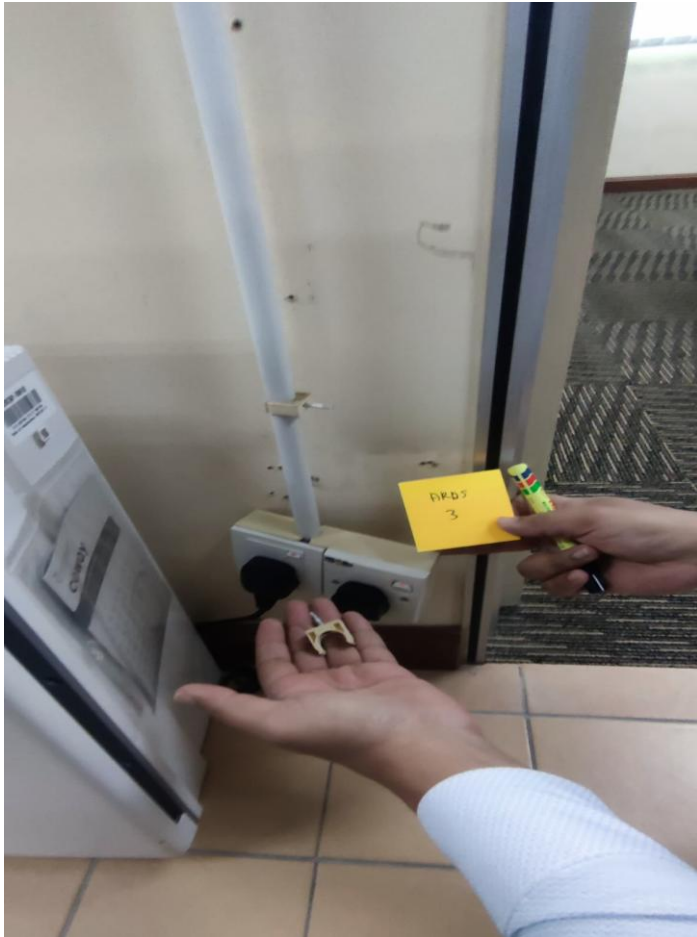
Penemuan: Suis dan paip elektrik tidak berada dalam keadaan baik
