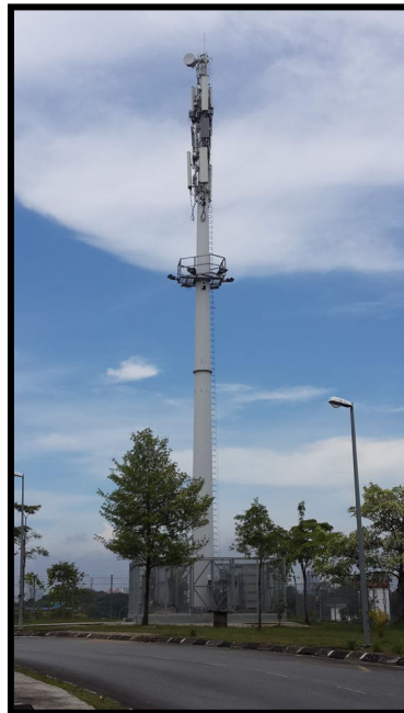
Gambar 4 – Menara telekomunikasi jenis Monopole
